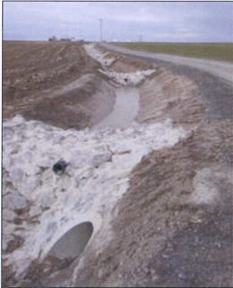
Begleitend zum Wegebau wurden solche Kaskaden angelegt, die Regen- oder Schmelzwasser von den Feldern nur allmählich ablaufen lassen.
